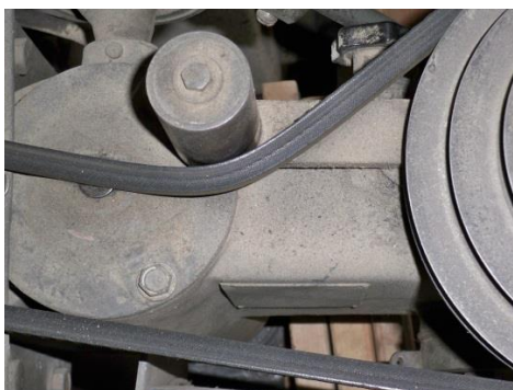
Rys. 5. Wiertarka stołowa – brak osłony na górnej części maszyny (fot. własna)
